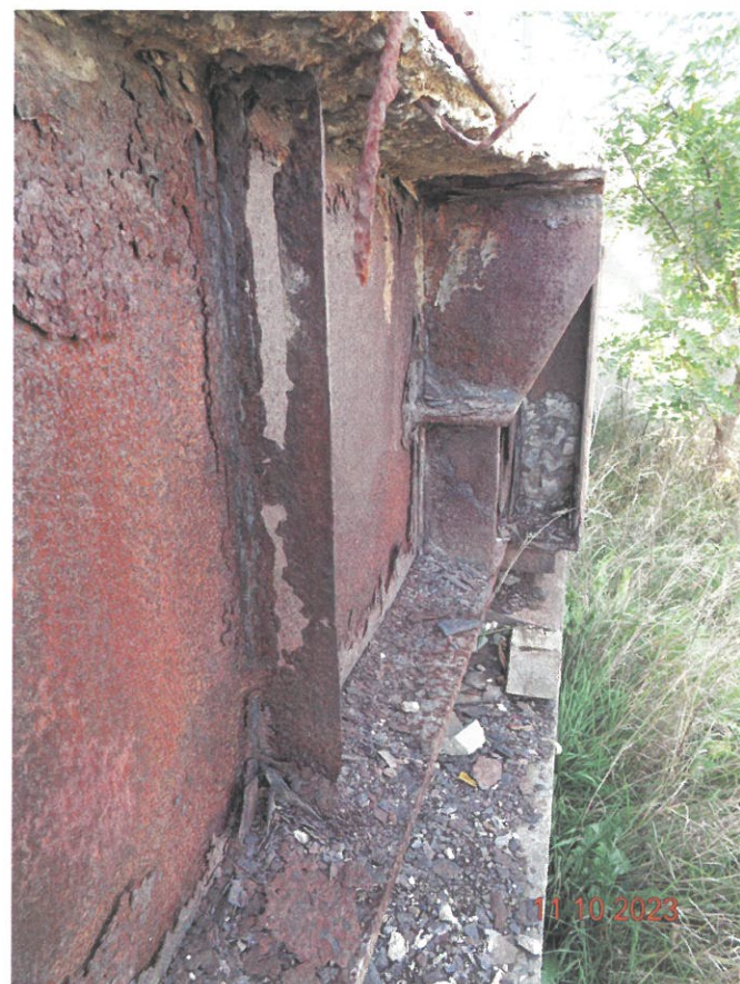
obr. 9 Korozní poškození koncového příčniku
