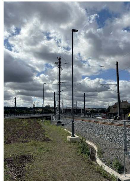
^ Samostatné osvětlovací stožáry v kolejišti
