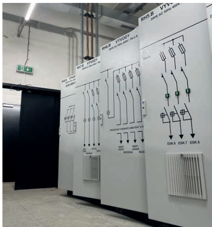
^ Rozvodna 0,4 kV transformovny 22/0,4 kV žst. Praha-Bubny
