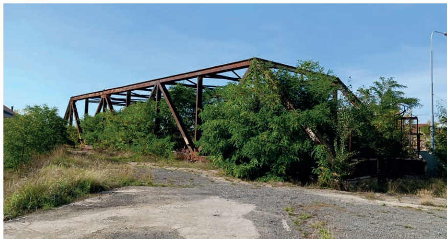
▲ Zarostlá konstrukce mostu ležící za zdi Škodovky
