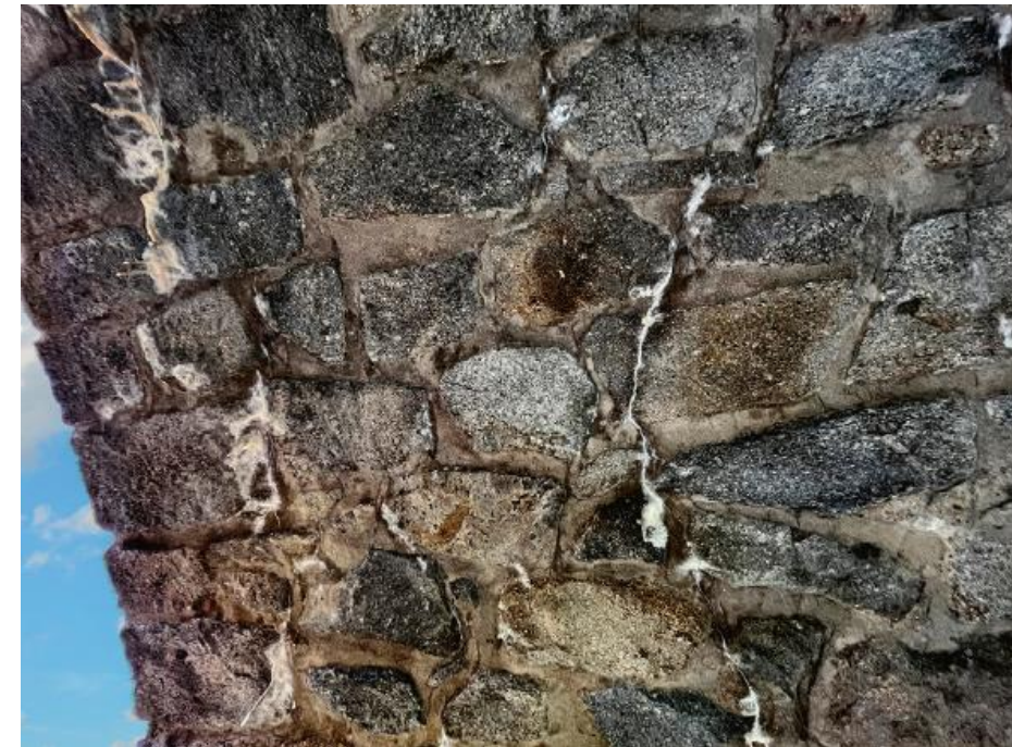
Stav v roce 2023 – silné aktivní zatékání a výluhy v podélných trhlinách
