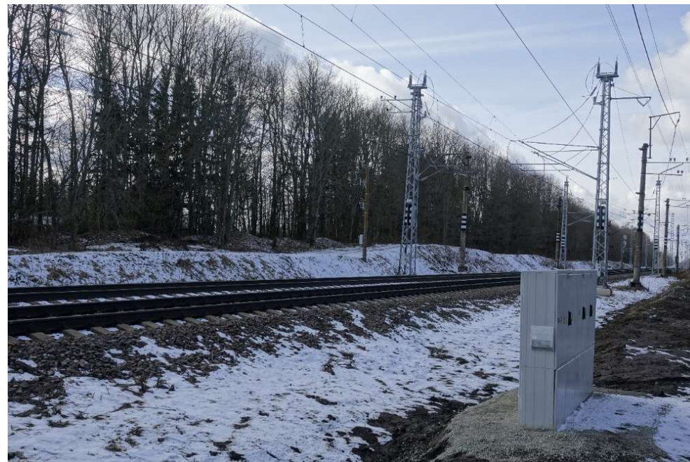
Železniční stanice Raasiku – ovládání odpojovačů
